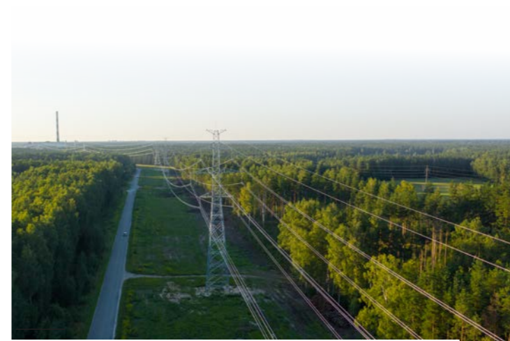
Internal line Riga CHP-2 - Riga HPP (LV) © Augstsprieguma tīkls
